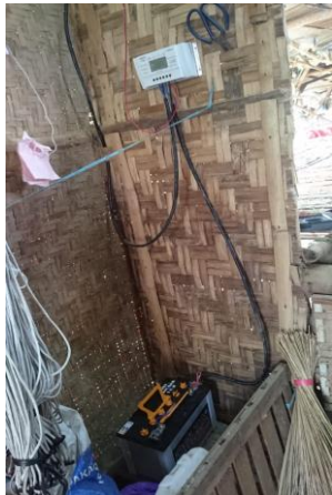
e. Solar Charge Controller dan Aki terinstall di kandang ayam pedaging milik Al Farouq
