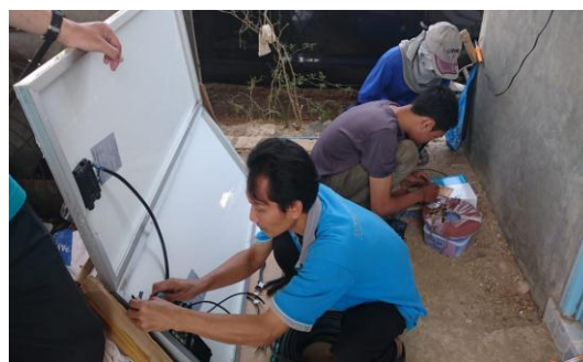
b. Persiapan instalasi PLTS oleh tim Pengabdian Kepada Masyarakat Sekolah Vokasi Universitas Gadjah Mada
