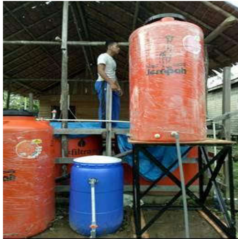
Gambar 5 Instalasi Penjernih Air
