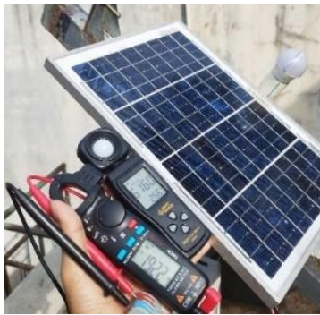
Gambar 10. Pengujian panel surya
