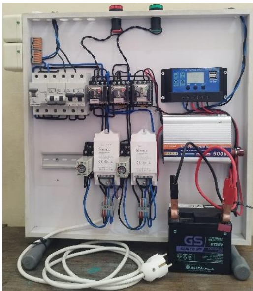
Gambar 6. Implementasi panel kelistrikan
