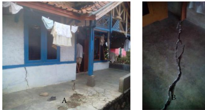
Keterangan : A=Kerusakan Bagian Luar; B= Kerusakan Bagian Dalam Gambar 7. Kerusakan Rumah Non Panggung di Kp. Tegalkoneng Sumber : Survei Lapangan, 2014
