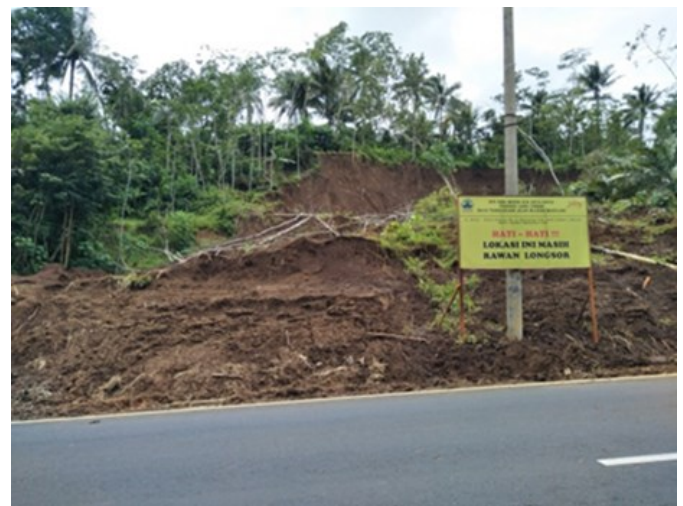
Gambar 6. Tanah longsor di kawasan bekas Danau Purba Borobudur (Sumber: Data Lapangan, 2019)
