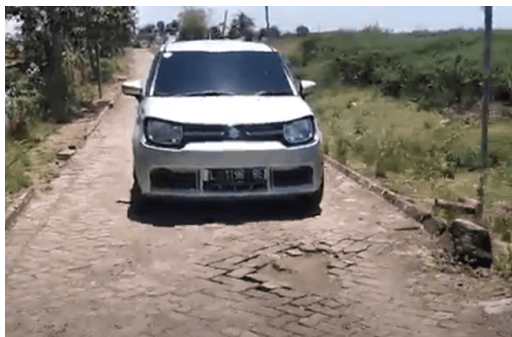
Gambar 6. Jalan akses menuju Makam Dewi Sekardadu yang masih rusak. Sumber: Dokumentasi Pribadi
