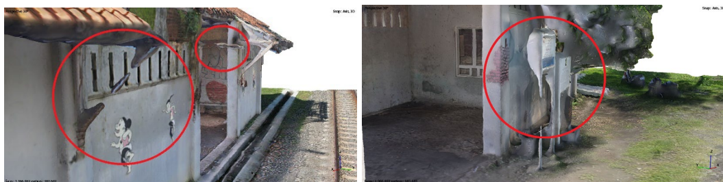
Gambar 11. Kesalahan pemodelan mesh pada penyangga atap stasiun (kiri) dan kesalahan bagian belakang plang penanda (kanan) akibat kurangnya foto yang diambil pada area tersebut
